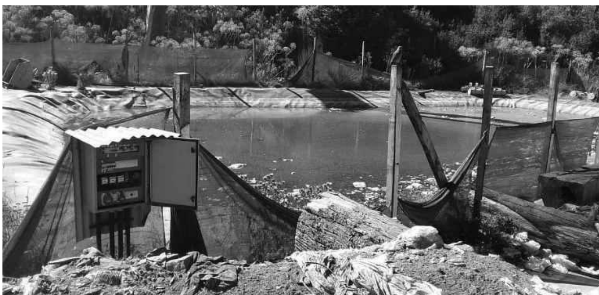
Foto N° 5: Falta de mantenimiento de la pileta de lixiviados, Sitio M7
